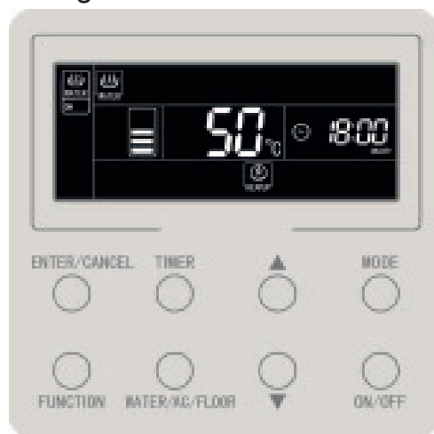
État effectif du temporisateur de production d'eau chaude
